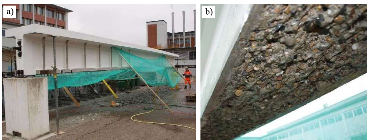
Rysunek 4.24. a) Dźwigar na stanowisku roboczym, b) Powierzchnia betonu po wykonaniu hydromonitoringu.
