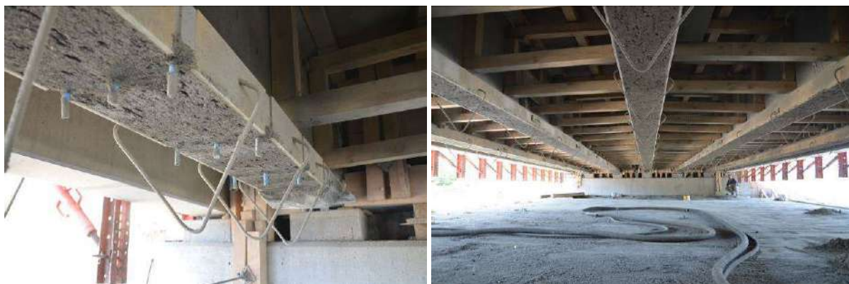
Rysunek 8.28. Widok dolnej powierzchni dźwigarów po reprofilacji.
