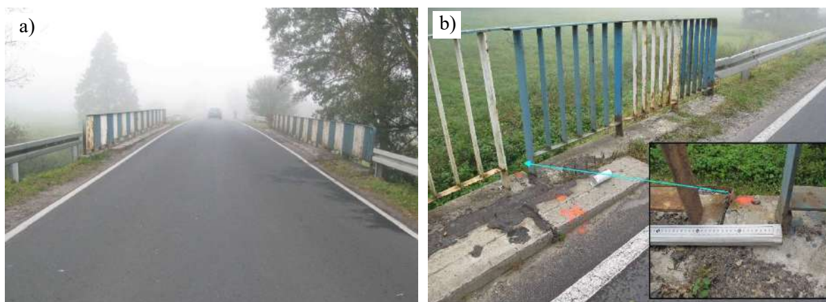
Rysunek 3.4. a) Widok wjazdu na most, b) Stan barier (Tarcopol, 2010).
