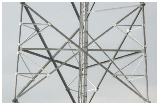
Fot. 2.25. Istniejące wzmocnienie krawężników (i krzyżulców) poprzez skrócenie ich długości wyboczeniowej
