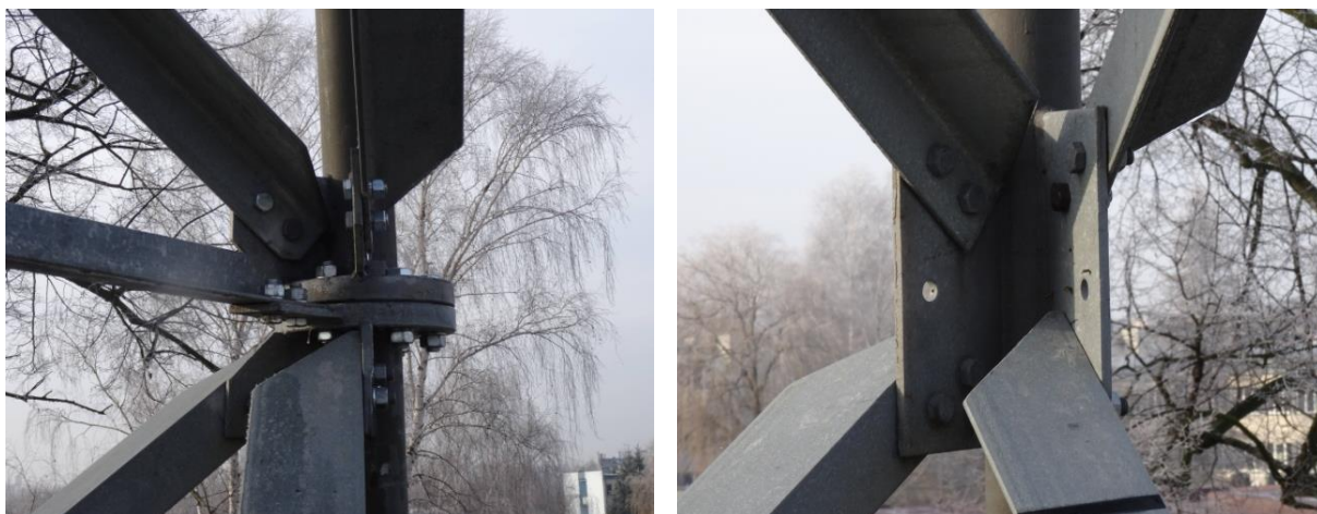
Fot. 5.1. Rozciągane węzły po przeprowadzonym eksperymencie w pełnej skali: połączenie pomiędzy segmentem S-6 i S-7 (po lewo) oraz połączenie krzyżulców z krawężnikiem w segmencie S-7 (po prawo)
