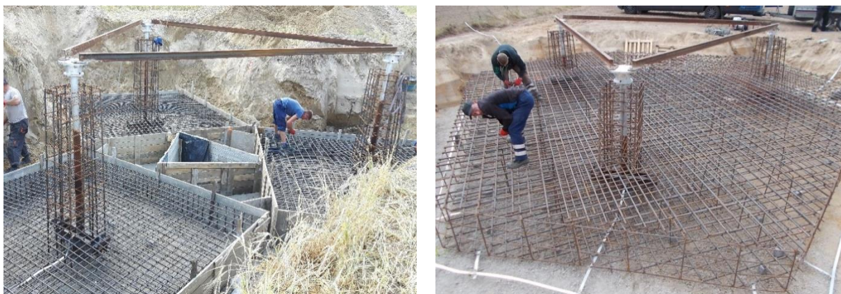
Fot. 2.8. Kotwy fundamentowe w fundamentach stopowych (po lewo) i fundamencie płytowym (po prawo) stabilizowane na czas betonowania za pomocą specjalnego szablону
