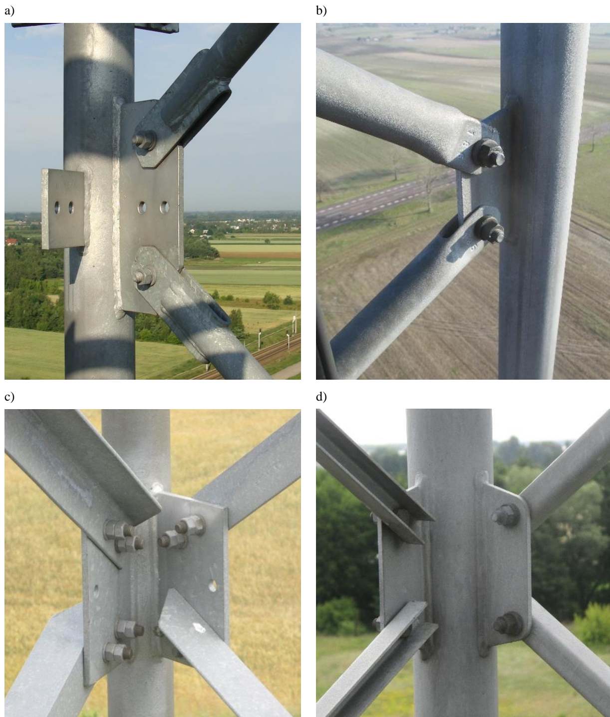
Fot. 2.4. Wybrane rozwiązania połączeń skratowania wieży z krawężnikami wykonanymi z rur bądź prętów pełnych (opis w tekście)
