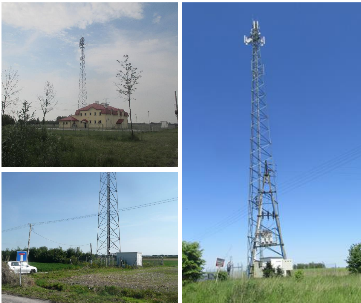
Fot. 3.1. Niekorzystna lokalizacja istniejących wież – sąsiedztwo zabudowań i napowietrznych linii energetycznych, nieutwardzony teren
