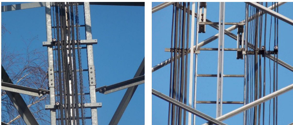
Fot. 2.22. Drabiny włazowo-kablowe: stopnie włazowe zlokalizowane za wspornikami kablowymi, po przeciwnych stronach prowadnic (po lewo); wsporniki kablowe mocowane do prowadnic, po obu stronach drabiny włazowej (po prawo)
