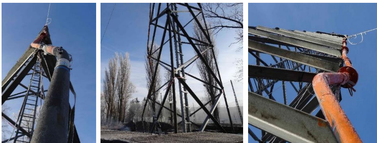
Fot. 3.7. Wyboczony krawężnik segmentu S-7
