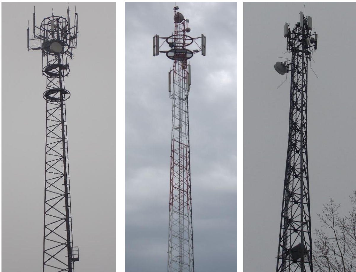
Fot. 2.17b. Stacje bazowe zlokalizowane na różnych typach konstrukcji wieżowych c.d.
