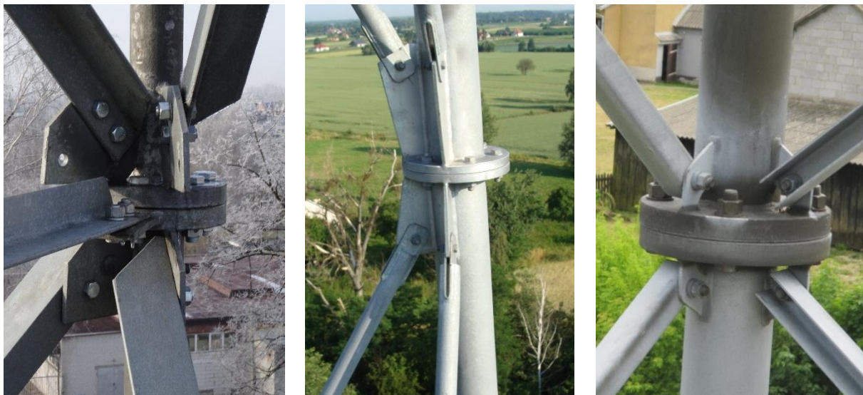
Fot. 2.3. Styki kólnierzowe pomiędzy krawężnikami wykonanymi z okrągłych prętów pełnych (po lewo) oraz rur (pośrodku i po prawo)
