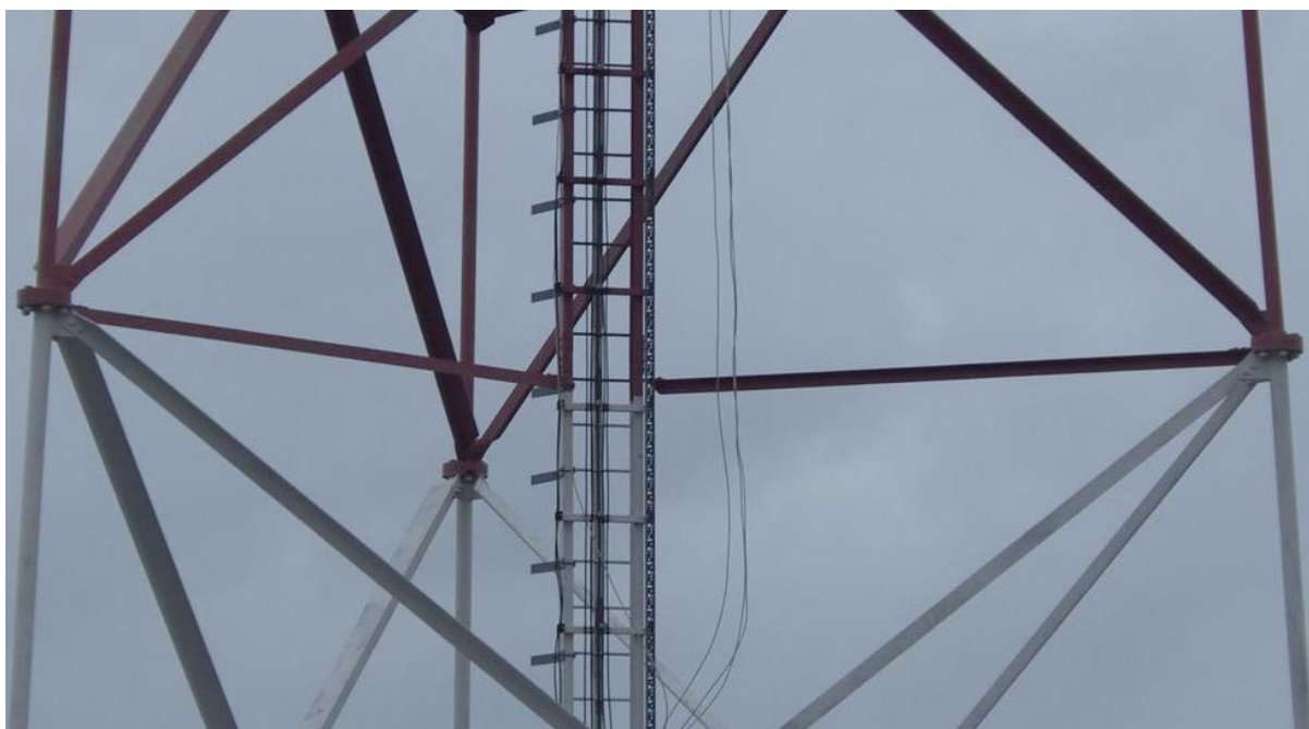
Fot. 3.3. Drabina włazowo-kablowa na istniejącej stacji bazowej
