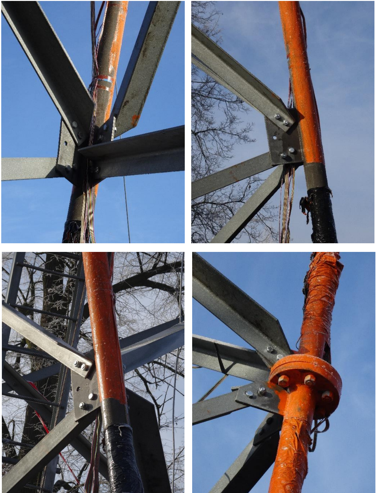
Fot. 3.8. Węzeł łączący skratowanie z wyboczonym krawężnikiem (u góry, po lewo na dole) oraz połączenie kołnierzowe pomiędzy segmentem S-6 – S-7 (po prawo na dole) po badaniu – brak widocznych deformacji
