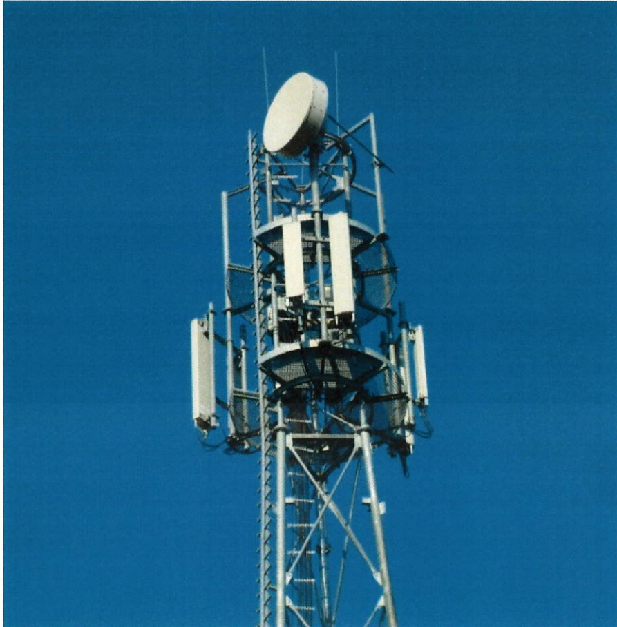
Fot. 2. Pomosty robocze oraz drabina włazowa i kablowa na szczycie konstrukcji wieżowej.
