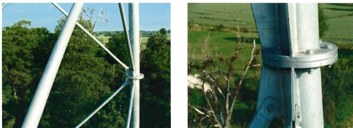
Fot. 4. Połączenia pomiędzy elementami skratowania a krawężnikami.
